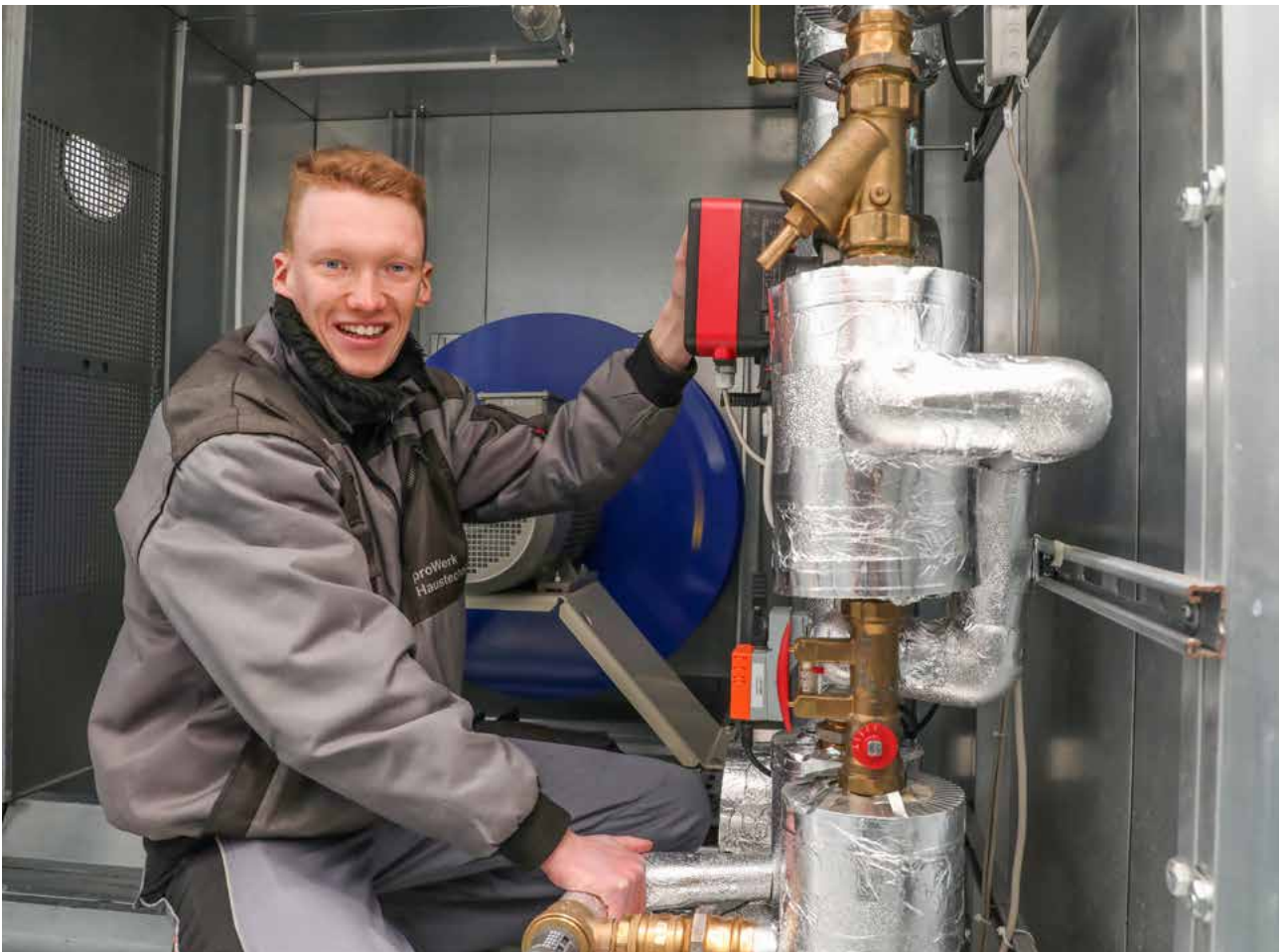
Paul Lode wartet die Brandmeldeanlage
