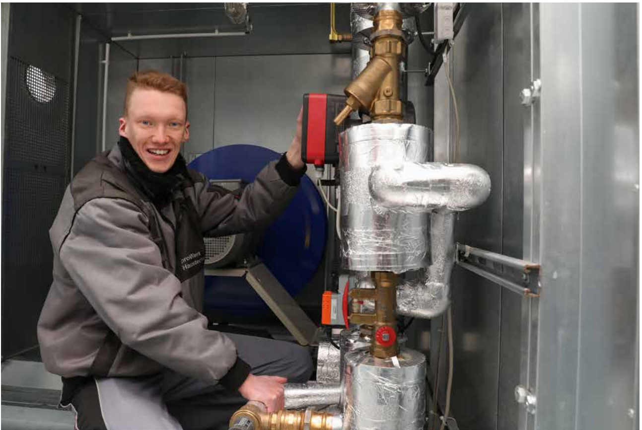
Haustechnik: Paul Lode überprüft die Brandmeldeanlage der Werkstatt Quellenhofweg
